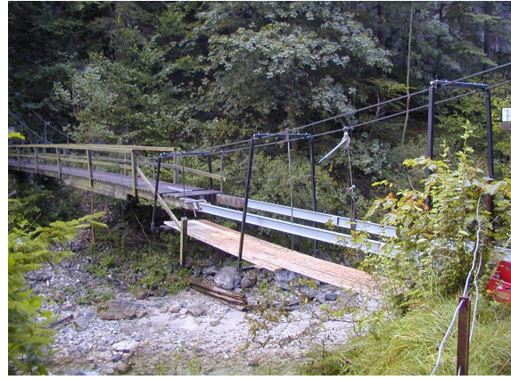
Umbau des Steges Teufelskirche : Austausch der Holz- gegen eine Stahlunterkonstruktion samt Gehbelag. Durch langjährige Erfahrung im Brückenbau ist es uns gelungen, ohne Gerüste und nur mit Hilfe der bestehenden Seile den Auftrag auszuführen.
